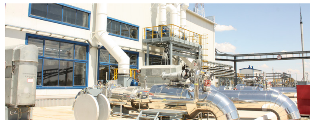
НПС-3 введена в эксплуатацию в ноябре 2015 года
