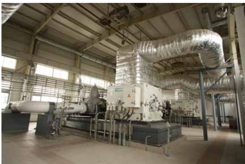
Магистральная насосная на НПС-7
