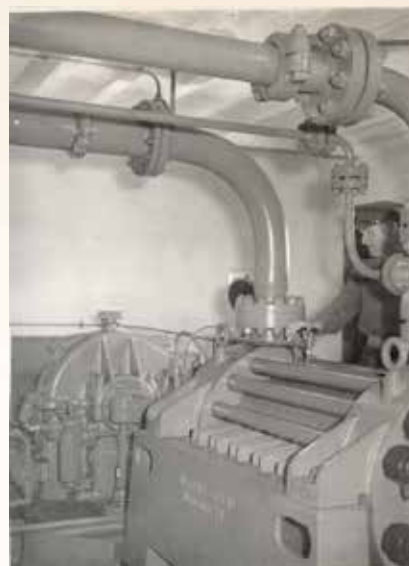
Машинный зал насосной станции
